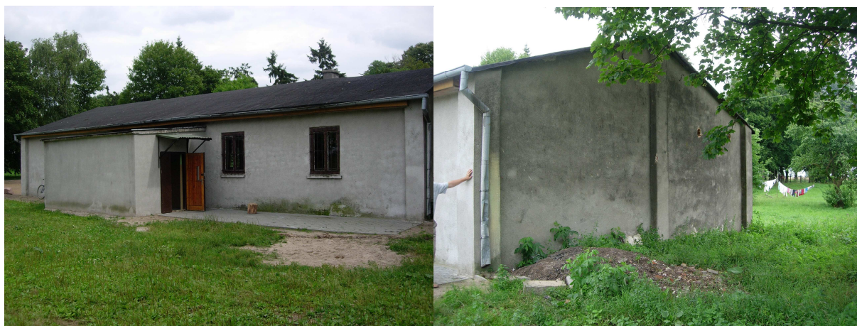
Ryc. 8 Świetlica wiejska w Półwieku Małym, wymagająca modernizacji elewacja budynku
